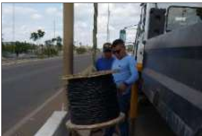
Foram mais de 4 mil metros de cabos roubados
